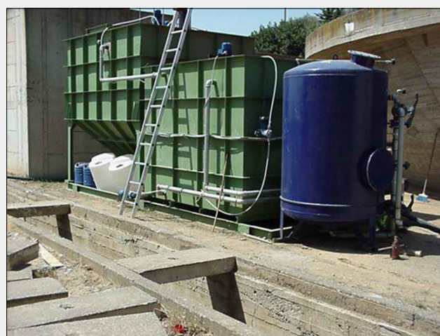
Fig. 3 - Ferrandina (MT). Prototipo del sistema di depurazione acque reflue urbane semplificato SI-UNIBAS.
